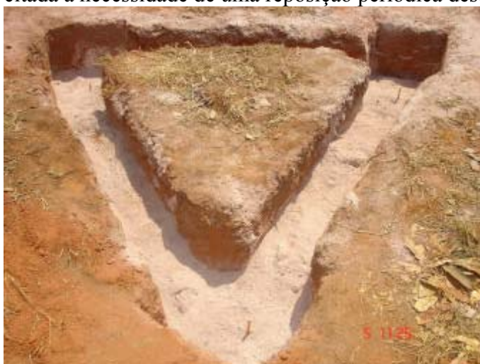
Figura 2 – Malha de Aterramento com Tratamento Químico do Solo.
